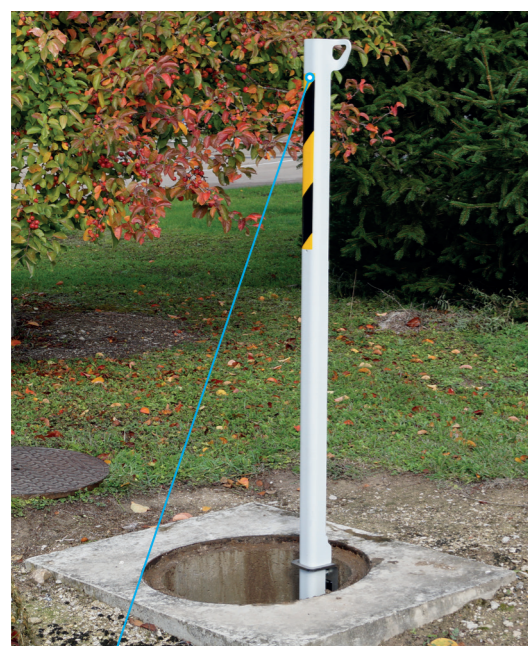
Punto de anclaje
